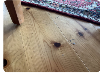
Eksempel på slitasje
