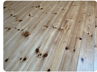
Eksempel på slitasje
