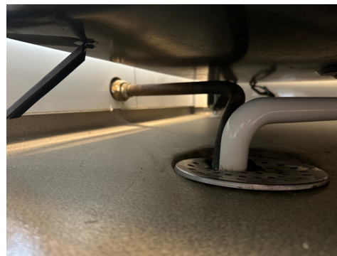
Rør rett gjennom vegg i ned fall sonen.
