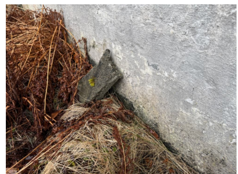
Jordmasse inntil grunnmuren. Jordmasse bør fjernes og erstattes med drenerende masser/pukk.
