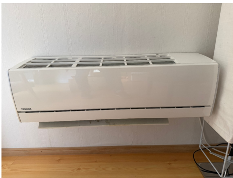
Varmepumpe med uttak i stue.
