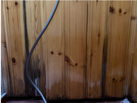
Fuktskader på panel i dusjsone.
