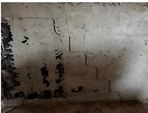
Sprekker i grunnmur.
