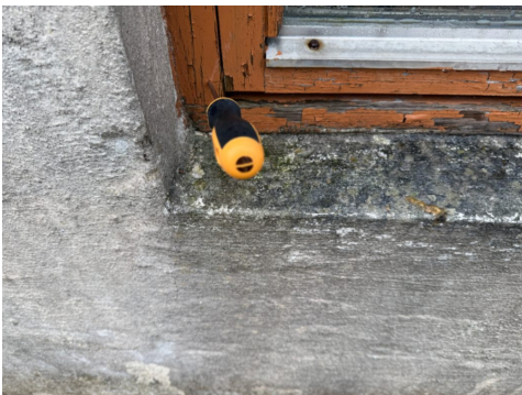
Råteskader i vindu i u-etg.
