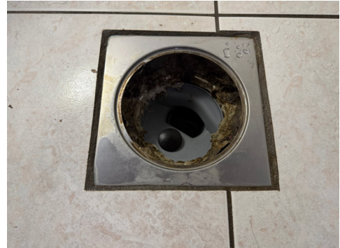
Plastsluk i dusjsone.
