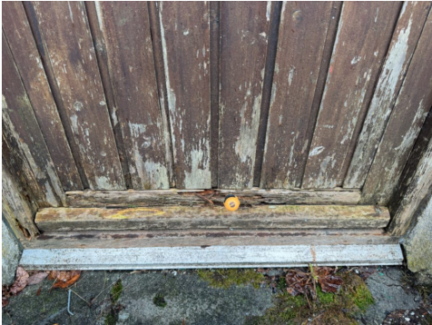
Råteskader i ytterdør i u-etg.
