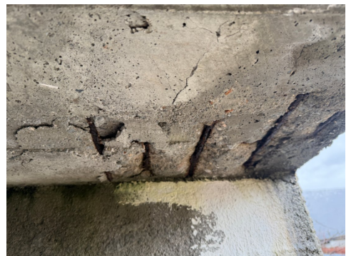
Synlig armeringsjern/betongskader under terrassen.
