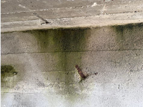
Fuktmerker/fuktnissig i ytre del av terrasse.
