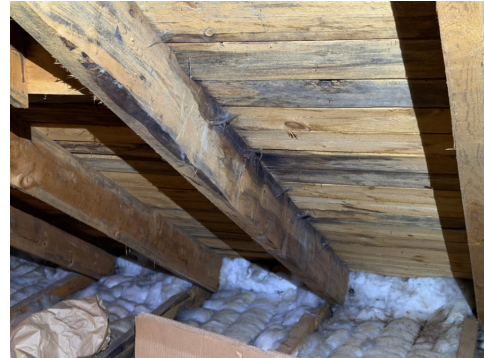
Misfarging/soppdannelse i sutak.
