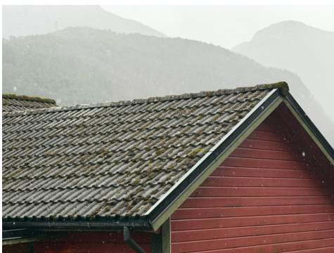
Taktekking sett fra bakkenivå. Taktekking er mosegrodd flere steder. Mose bør fjernes.
