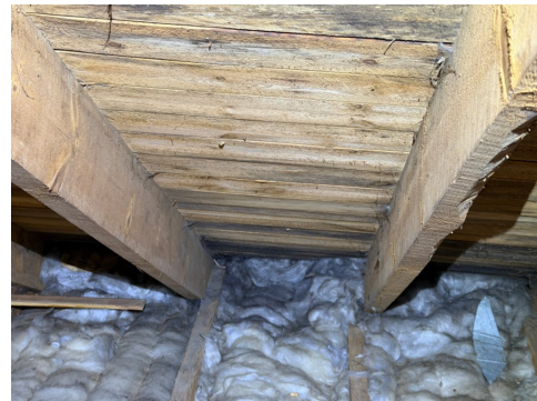
Misfarging/soppdannelse i sutak.
