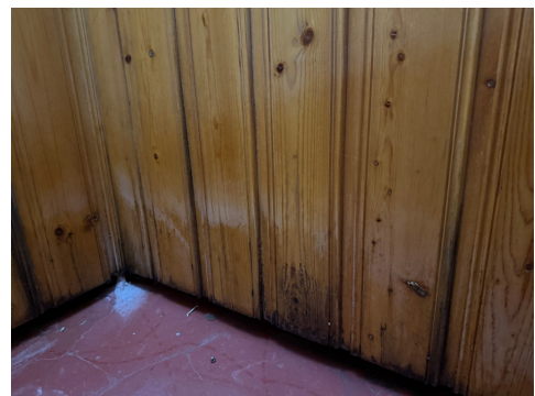
Fuktskader på panel i dusjsone.
