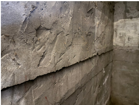
Sprekker i grunnmur.
