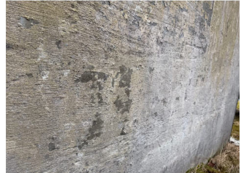
Malingsflass på grunnmur.
