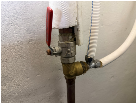
Stoppekran i vaskekjeller i u-etg.
