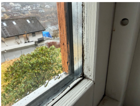
Misfarging/soppdannelse i karm på vindu på hovedsoverom.
