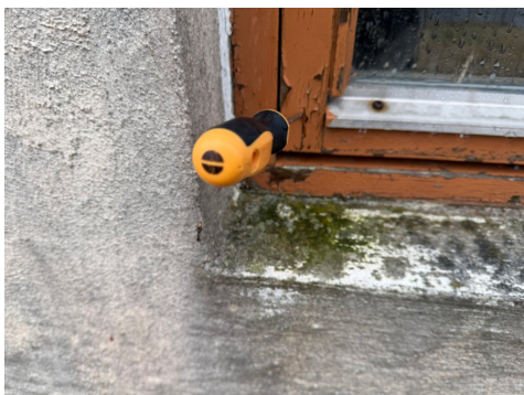
Råteskader i vindu i u-etg.
