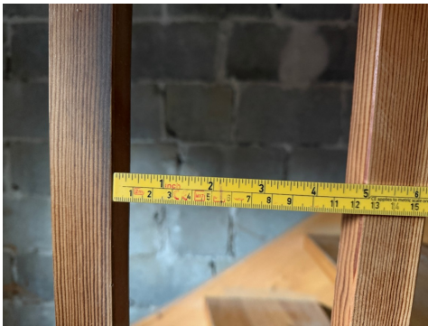
Åpninger i rekkverk er større enn 10 cm. Avvik registrert i HMS punkt.
