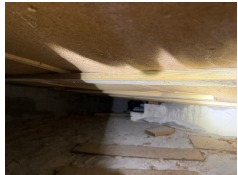
Kryp kjeller har kun inspeksjonsmulighet via ventil/åpning i grunnmur.
