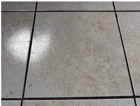
Sprekker i gulvfliser.
