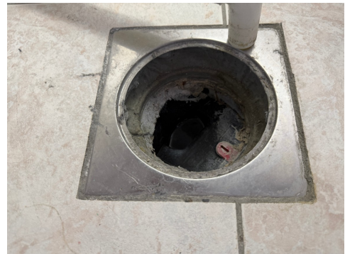
Plastsluk i gulv.
