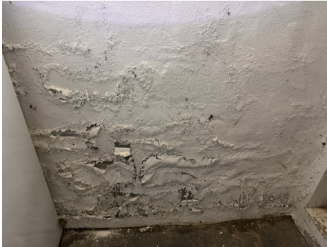
Saltutslag i vaskekjeller.
