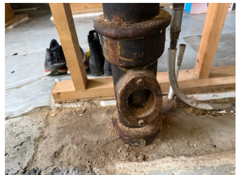
Stakeluke. Store rustskader på avløpsrør.
