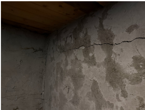
Sprekker i grunnmur.
