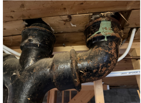
Store rustskader på avløpsrør.
