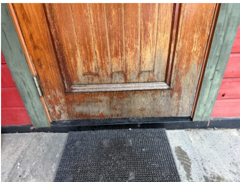
Slitasje i nedre del av ytterdør. Ytterdør bør slipes/behandles om den ikke skal skiftes.
