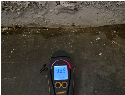
Forhøyede fuktverdier i betonggulv.
