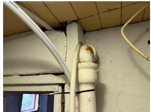
Store rustskader på avløpsrør.
