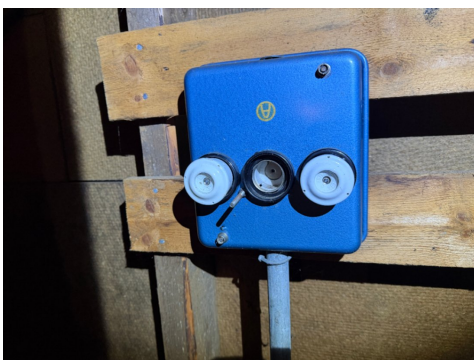
Eldre inntaksikring på koffertloft (skrusikringer).
