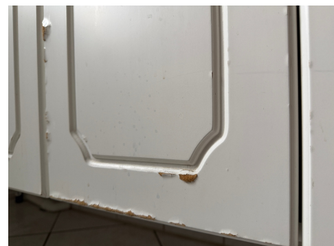
Fuktutsvelling i nedre del av baderomsinnredning.
