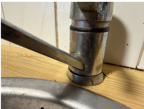
Fuktutsvelling i benkeplate rundt blandebatteri/kran.
