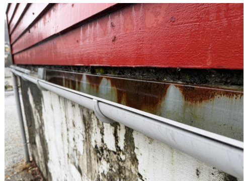
Rust på beslag v/ takrenne.
