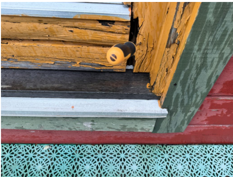
Råteskader i terrassedør.
