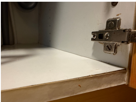
Fuktutsvelling i skapbunn under vask.
