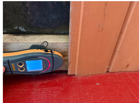
Forhøyede fuktverdier ble registrert. Takkonstruksjon i overbygd del v/ inngangsparti har råteskader.
