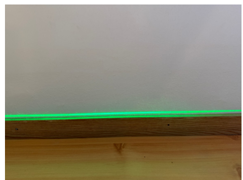
Bilder viser skjevheter i gulv i stue.
