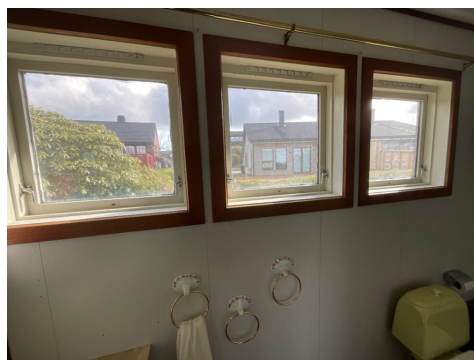
Punkterte vinduer på bad lot seg ikke åpne på enkelt vis. Vinduene har lufteventile
