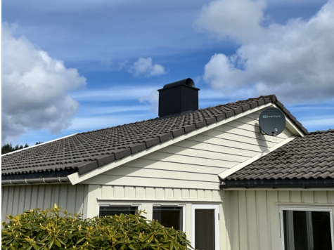
Pipebeslag over pipe over tak.
