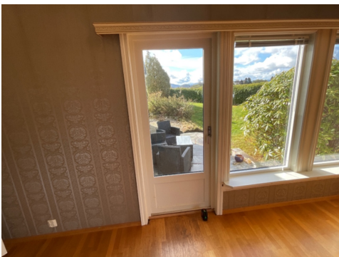
Terrassedør med utgang fra stue. Isolert glassfelt og brystning. Åpner, lukker og låser fint. Metallbeslag over dør
