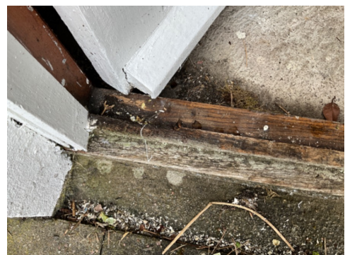
Råte på terskel, kjellerdør
