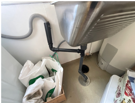
Røropplegg under skyllekum på vaskerom.
