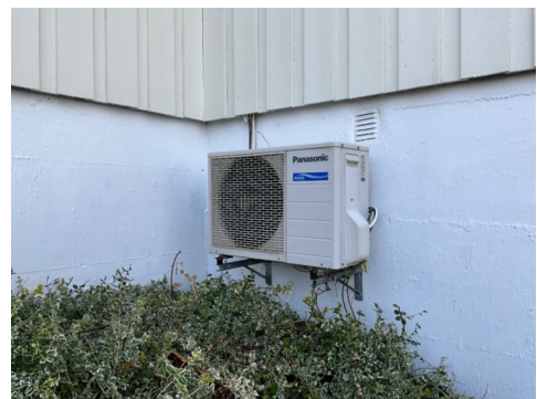
Aggregat, Panasonic varmpumpe, montert på yttervegg.
