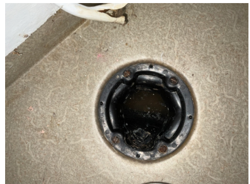
Plastsluk. Synlig belegg/ membran klemt under klemring.
