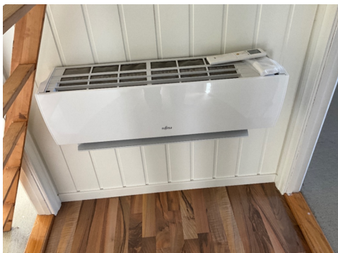
Fujitsu varmepumpe i gang, hovedetasje.
