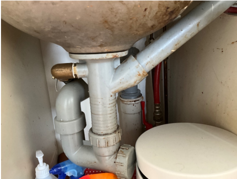
Røropplegg under kjøkkenvask.
