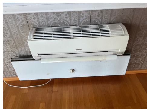
Panasonic varmpumpe i stue.
