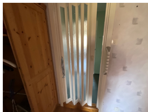
Folde dør trenger reparasjon eller utskifting.
