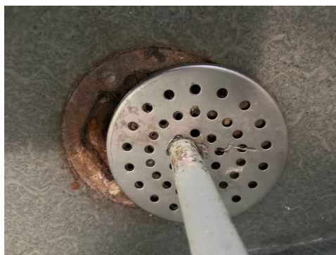
Sluk fra byggeår på vaskerom.
