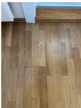
Sprekker i parkett ved balkondør
