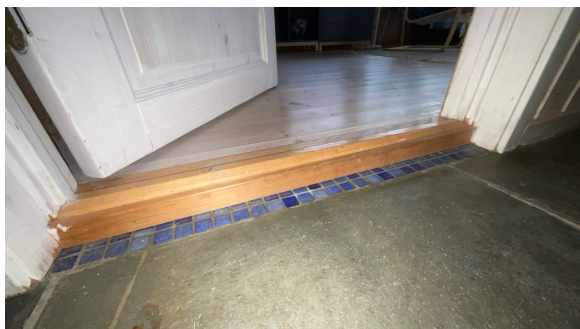
Nivåforskjell på gulv mellom rom.
