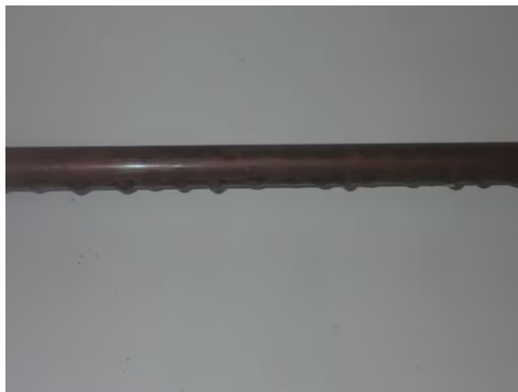
Kondensering på kobberrør.
