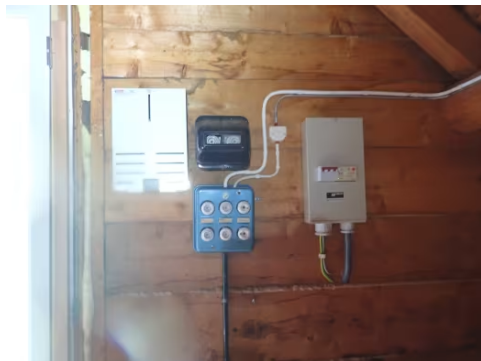
Sikringstavle hovedinntak på kaldtloft.
