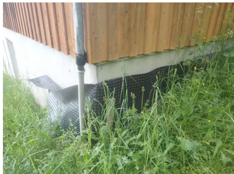
Manglende topplst på grunnmursplast.
