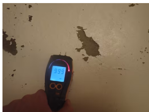
Fuktopptrekk i betongvegg i trapperom.
