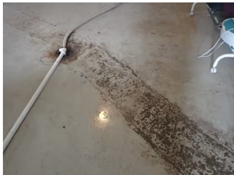
Skade i overflate gulv.
