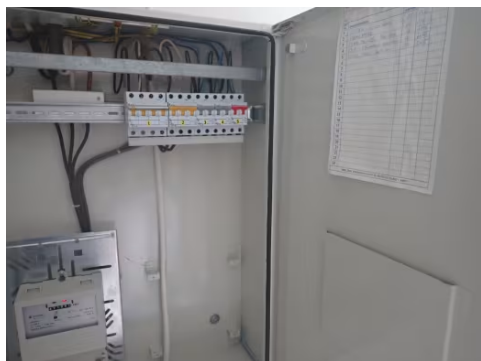
Sikringsskap i underetasje. 2 kurser på 25 amp. Eldre type måler uten fjernavlesning.
