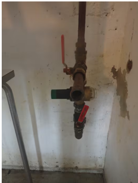
Hovedstoppekrane på bad.
