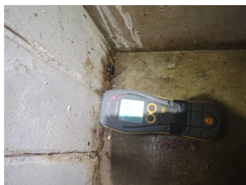
Råte i trevegg med fuktopptrekk.
