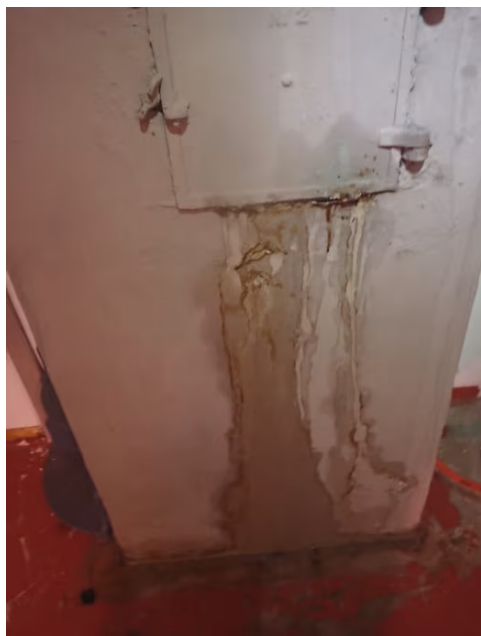
Fukt ved sotluke i underetasje.
